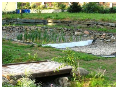
Příklad čističky instalované v rámci projektu PASSES.
